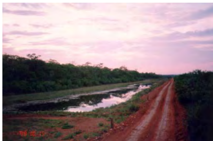
Figura 3. Cruce de la carretera actual con la brecha del gasoducto Bolivia – Brasil. Fuente: EEIA.
